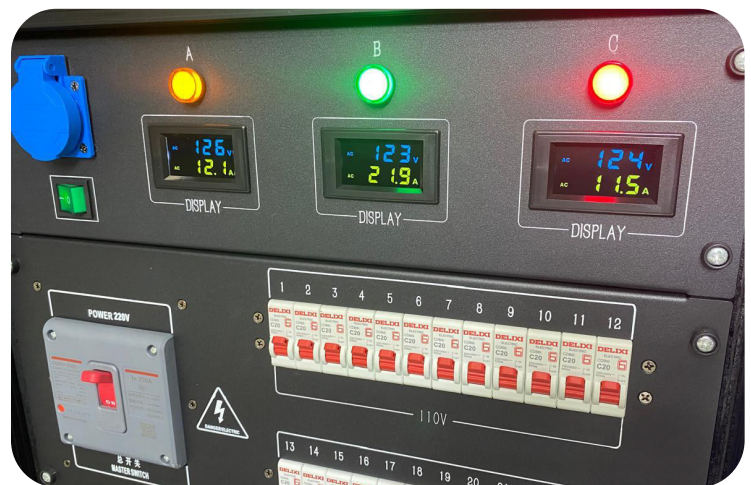
Break principal e instrumento de medición por fase
